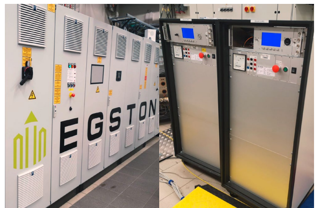
National Smart Grid Laboratory: Netznachbildung für AC und DC (links) und zwei 2-level VSCs (rechts)
